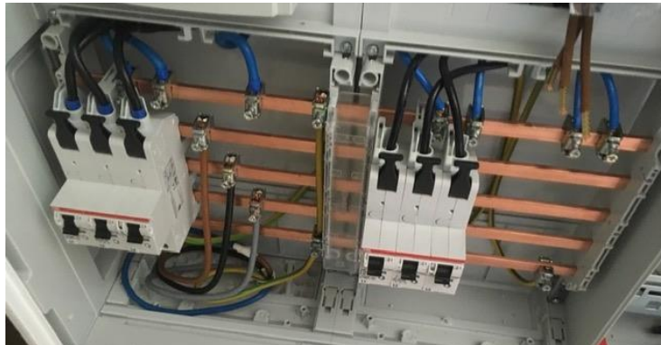
Grössere Stromschielen für 22 kW Sonnencharger (Wallbox)
